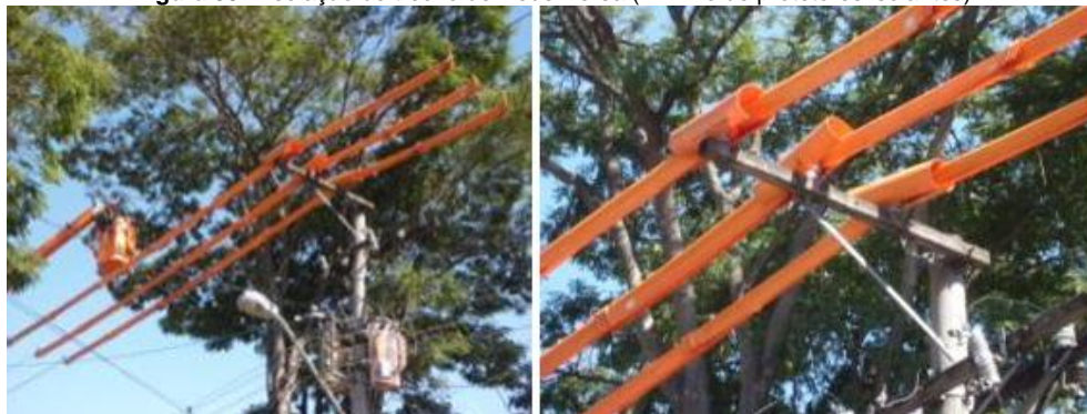
Figura 40 – Isolação de trecho de Rede Aérea – (Com equipamento desenergizado)
