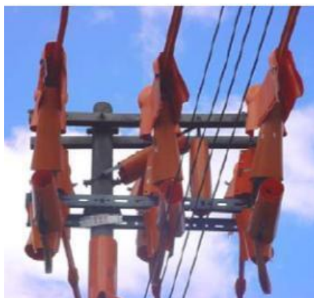
Figura 41 – Isolação de estruturas de chaves
